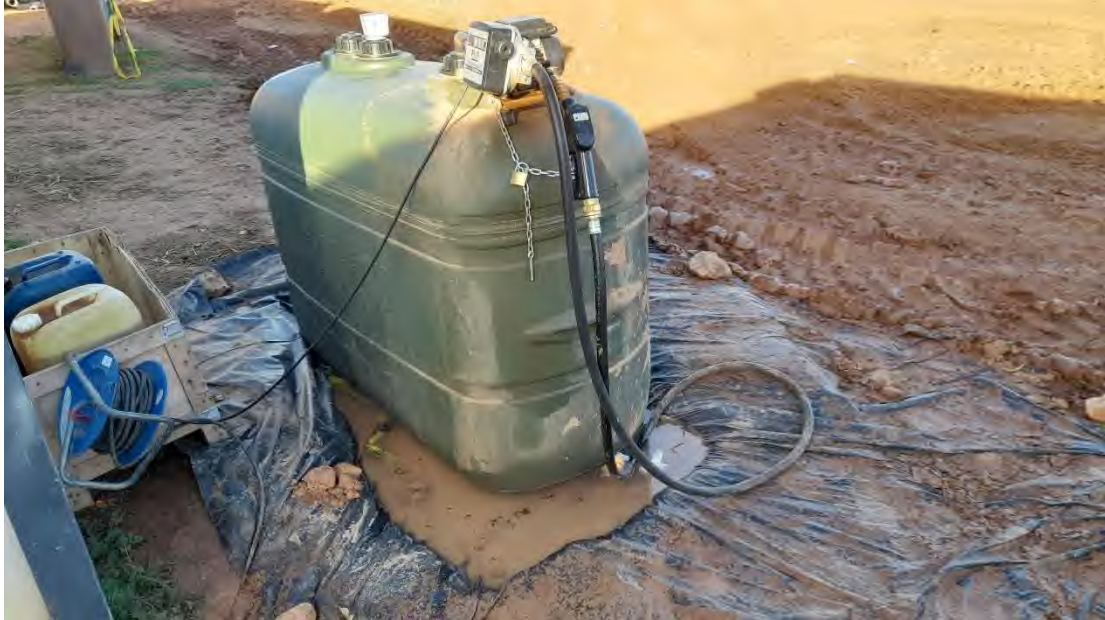
Foto 9. Depósito de gasoil en la zona de oficinas e instalaciones auxiliares.
