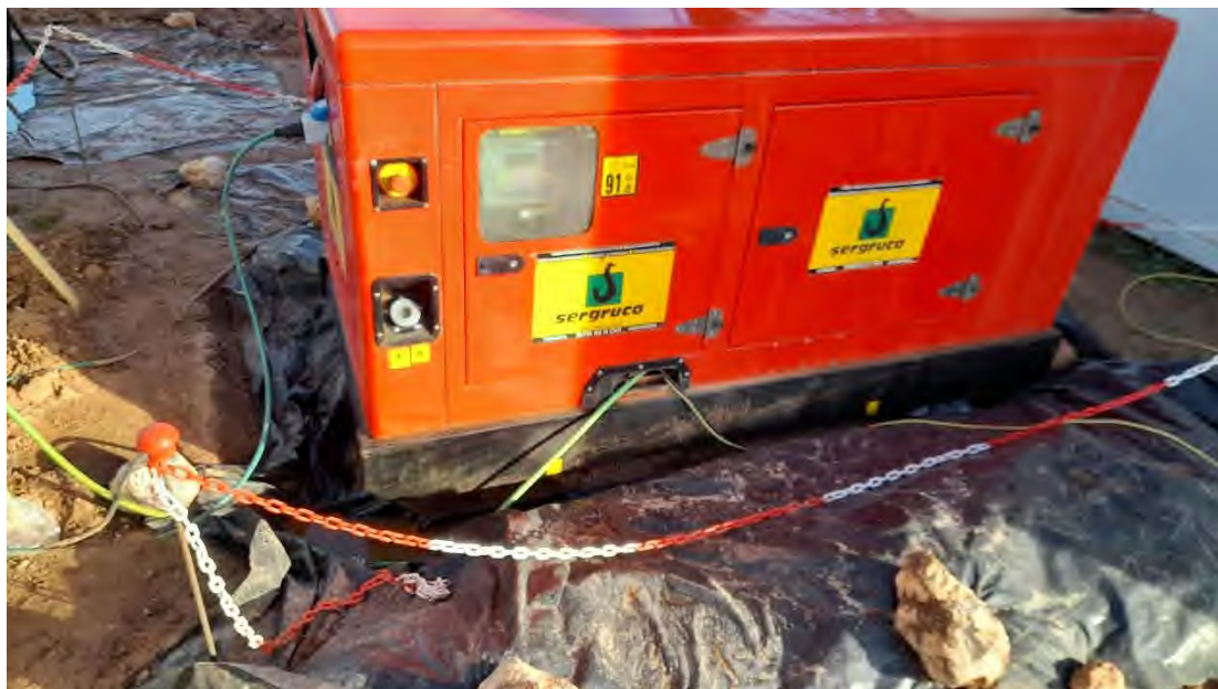
Foto 11. Grupo electrógeno en la zona de oficinas e instalaciones auxiliares
