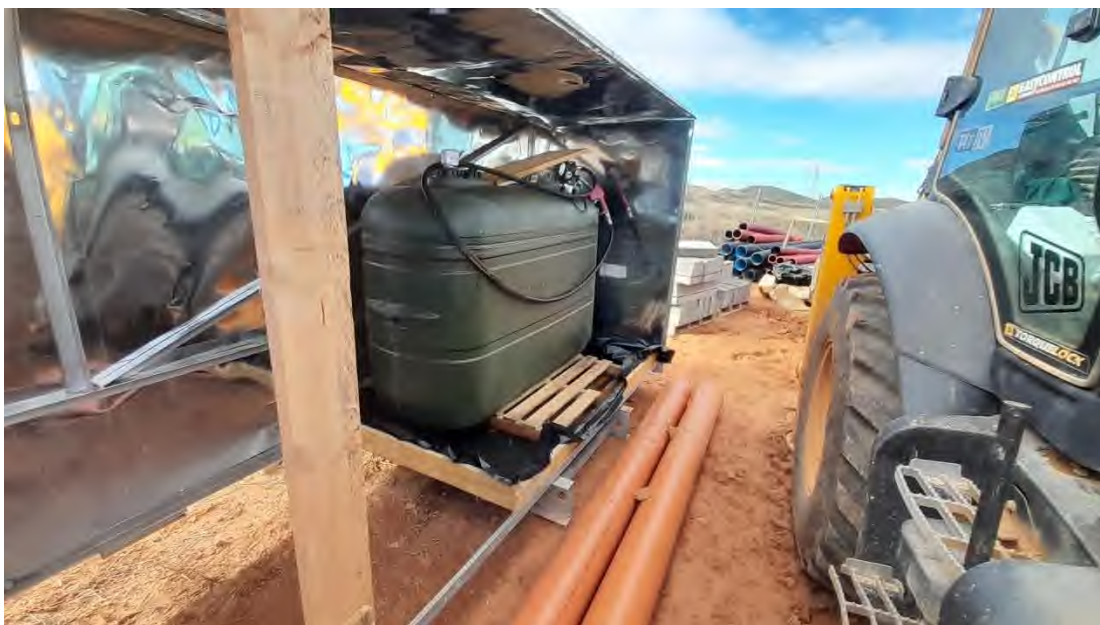
Foto 22. Depósito de gasoil en zona de instalaciones auxiliares.
