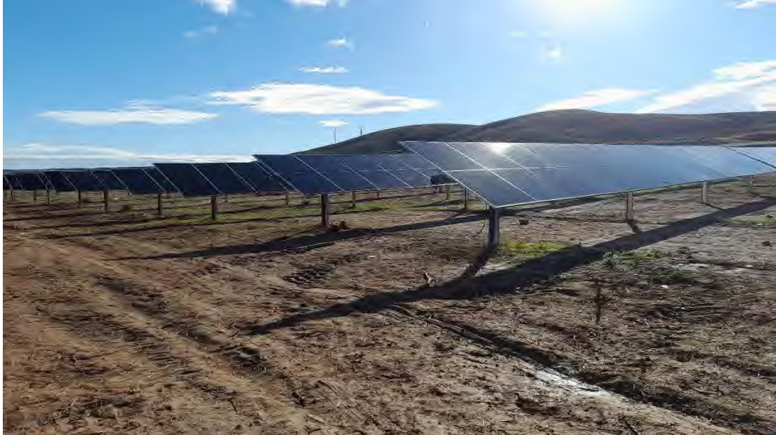
Foto 15. Vista general de zona con seguidores con paneles montados
