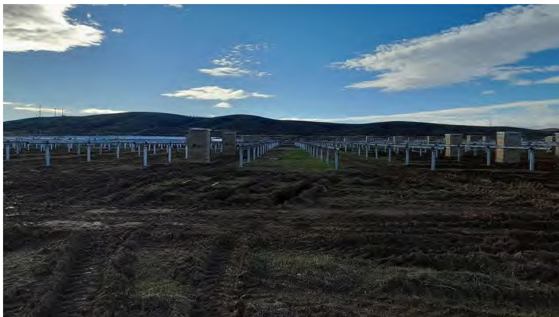
Foto 14. Vista general de zona con seguidores montados y paneles acopiados para su montaje
