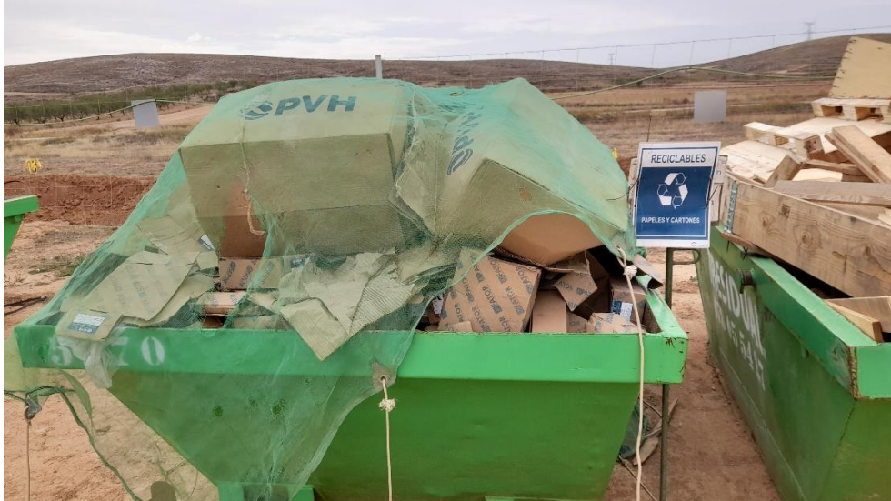
Foto 3. Zona de residuos de construcción y demolición (RCD). Contenedor de papel y cartón.
