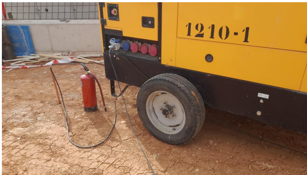
Foto 21. Grupo electrógeno en zona de oficinas
