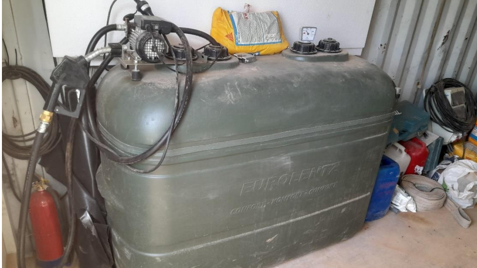
Foto 19. Depósito de abastecimiento de gasoil para grupos electrógenos
