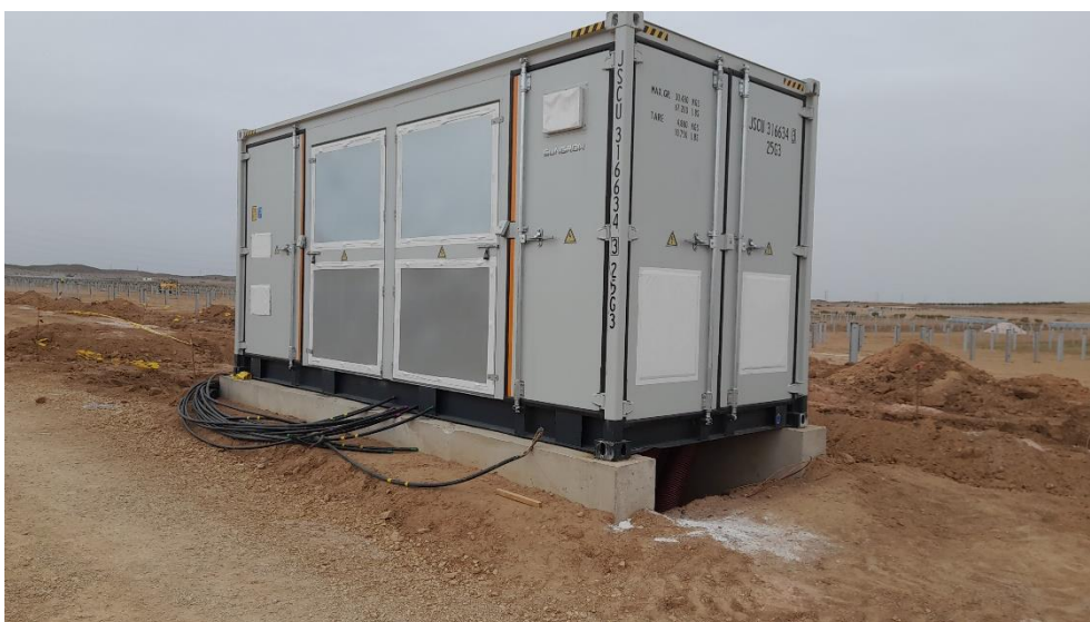
Foto 10. Centro de transformación
