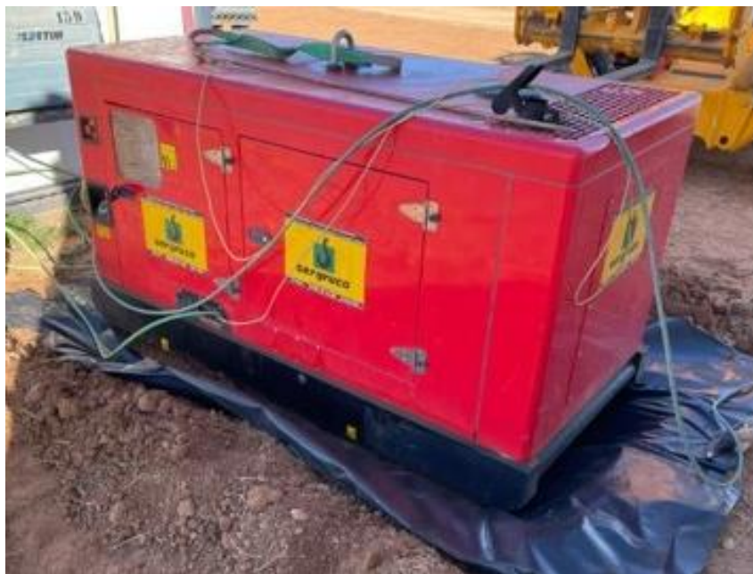
Foto 7. Grupo electrógeno en la zona de oficinas
