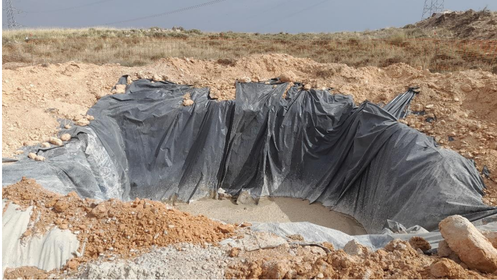
Foto 25. Zona de lavado de canaletas de camiones hormigonera
