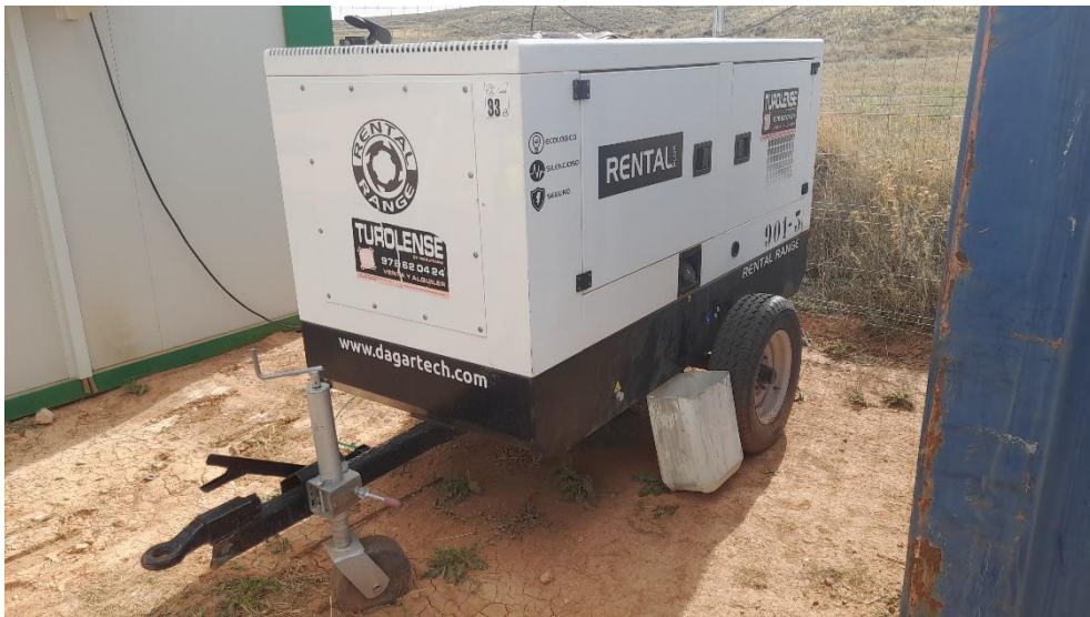
Foto 20. Grupo electrógeno en zona de oficinas
