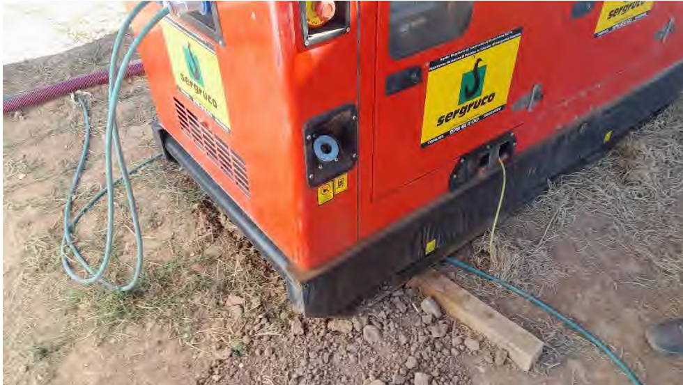
Foto 5. Grupo electrógeno en la zona de oficinas
