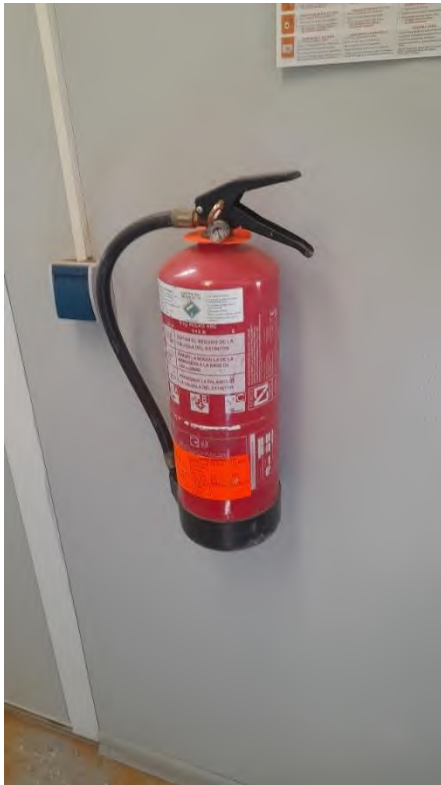
Foto 24. Extintor de incendios en el interior de casetas de oficinas.
