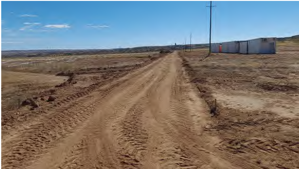
Foto 8. Avance de la ejecución de viales. Zona de oficinas localizada en la margen derecha y zona de seguidores en la margen izquierda (hincas depositadas en el suelo)
