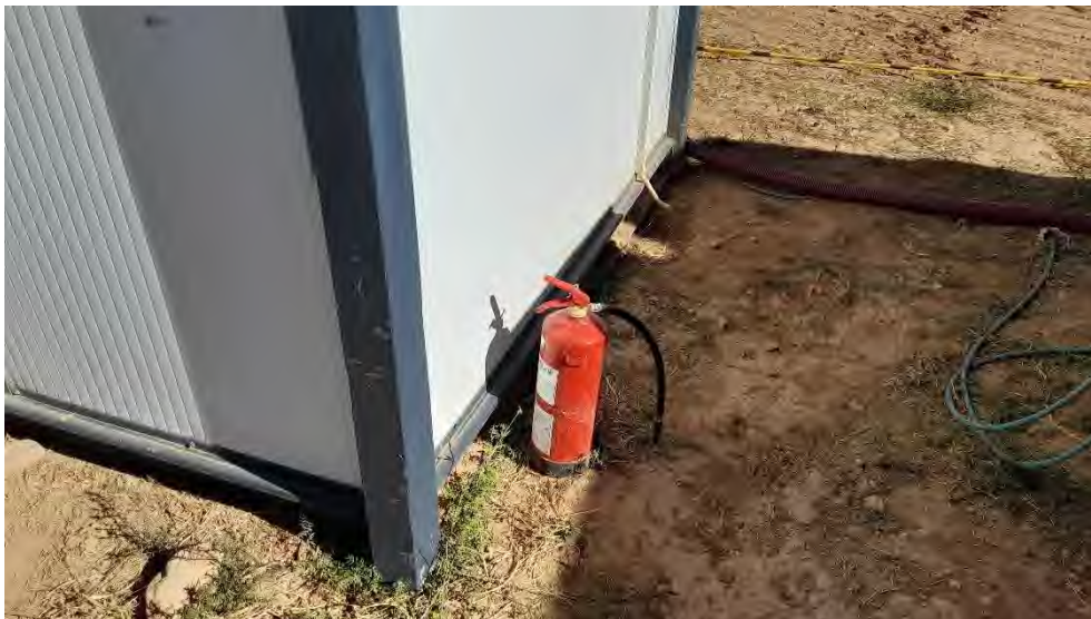
Foto 6. Medios de extinción en la zona de oficinas. Detalle de extintor de incendios junto a grupo electrógeno.
