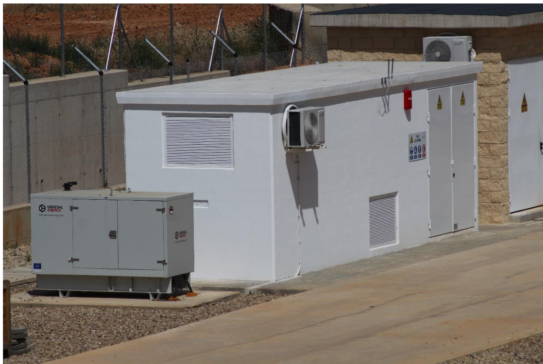
Foto 10. Grupo electrógeno y sala de control de subestación.
