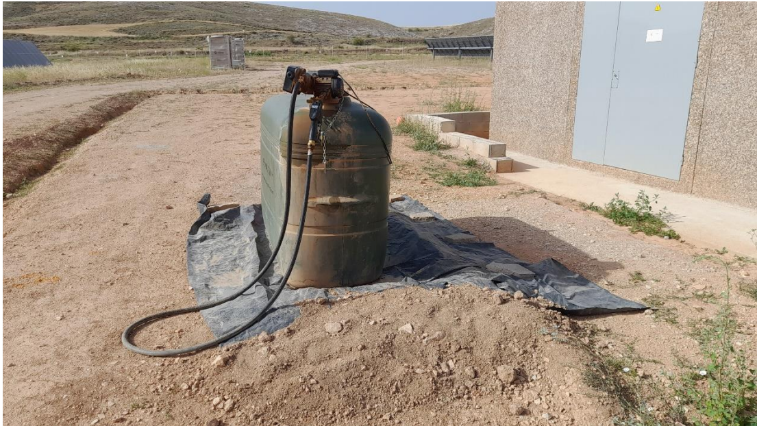
Foto 1. Depósito de gasoil en la zona de oficina de O&M
