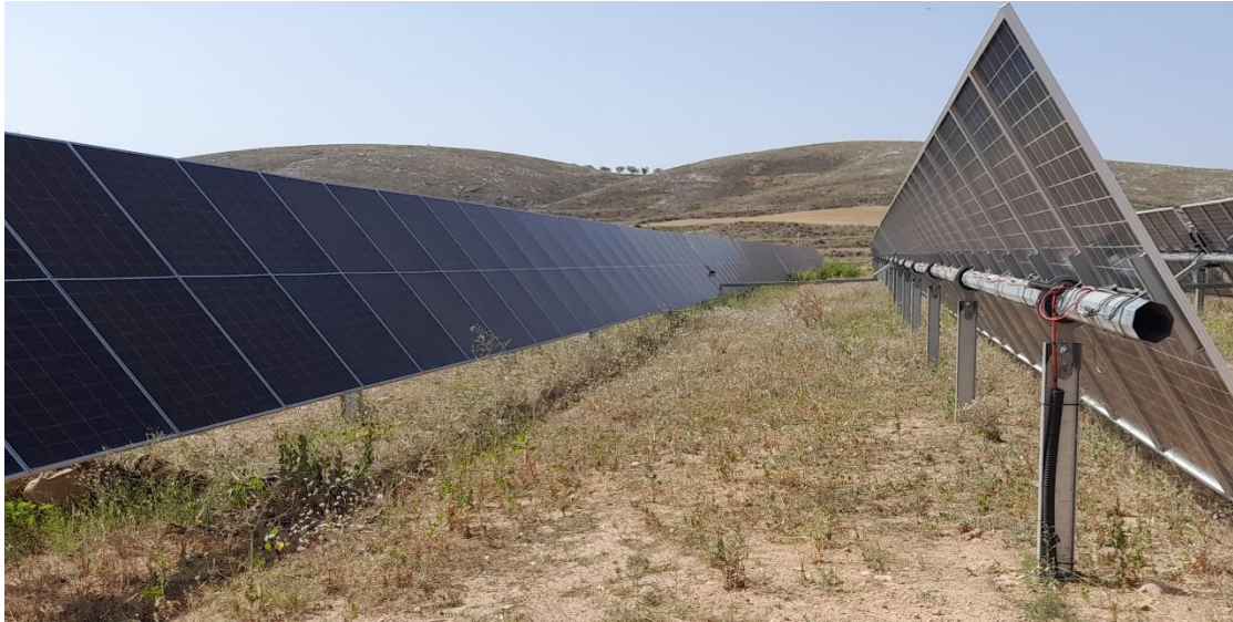
Foto 7. Presencia de cubierta herbácea bajo seguidores y entre strings.
