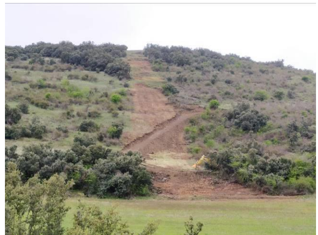
Imagen n.º 3 Acceso ejecutado al apoyo n.º 3 por el interior de la calle desbrozada
